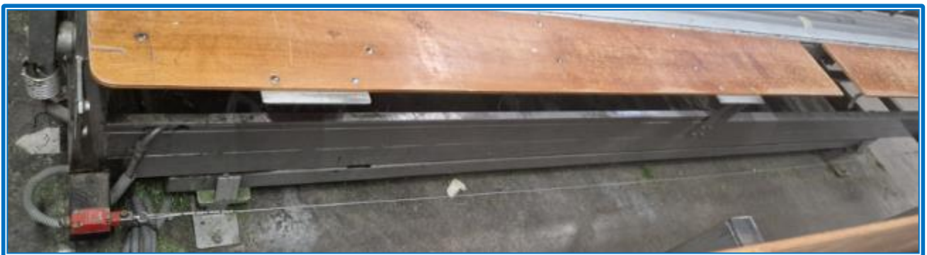
(Photo n°22 : Vue de l'interrupteur à câble)
