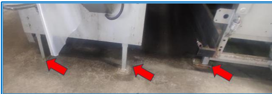
(Photo n°30 : Vue des embases de la machine)
