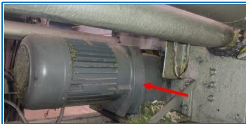
(Photo n°07 : Vue du motoréducteur entraînant les rouleaux motorisés)
