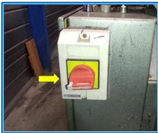
(Photo n°33 : Vue du sectionneur-interrupteur)
