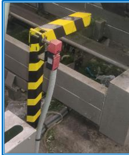
(Photo n°20 : Vue de l'interrupteur de position de sécurité)
