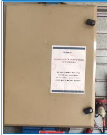
(Photo n°25 : Vue de l'armoire électrique)
