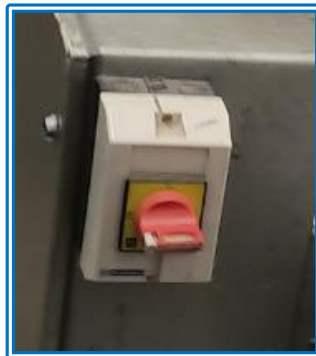
(Photo n°26 : Vue de l'interrupteur-sectionneur)
