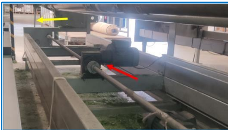
(Photo n°08 : Vue du motoréducteur et de la bielle)
