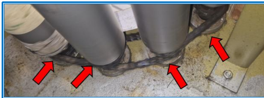
(Photo n°55 : Vue de la partie inférieure de l'enrouleur)
