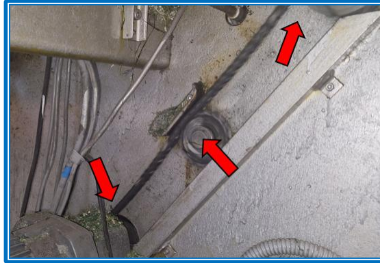
(Photo n°54 : Vue de la partie inférieure de l'enrouleur)
